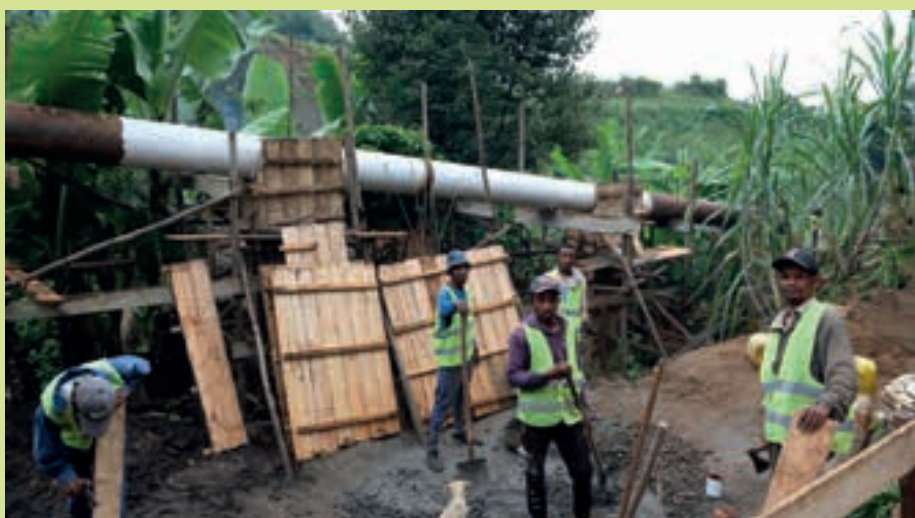
Les habitants de la communauté de Mandialaza participent à la construction de la centrale hydroélectrique. (Photo : Léa Dezprez)
